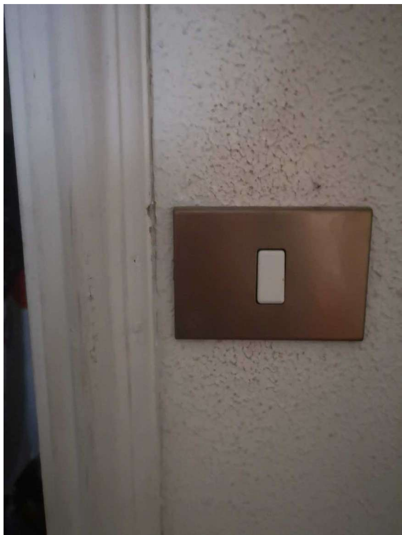
Tipologia placche e frutti impianto elettrico
