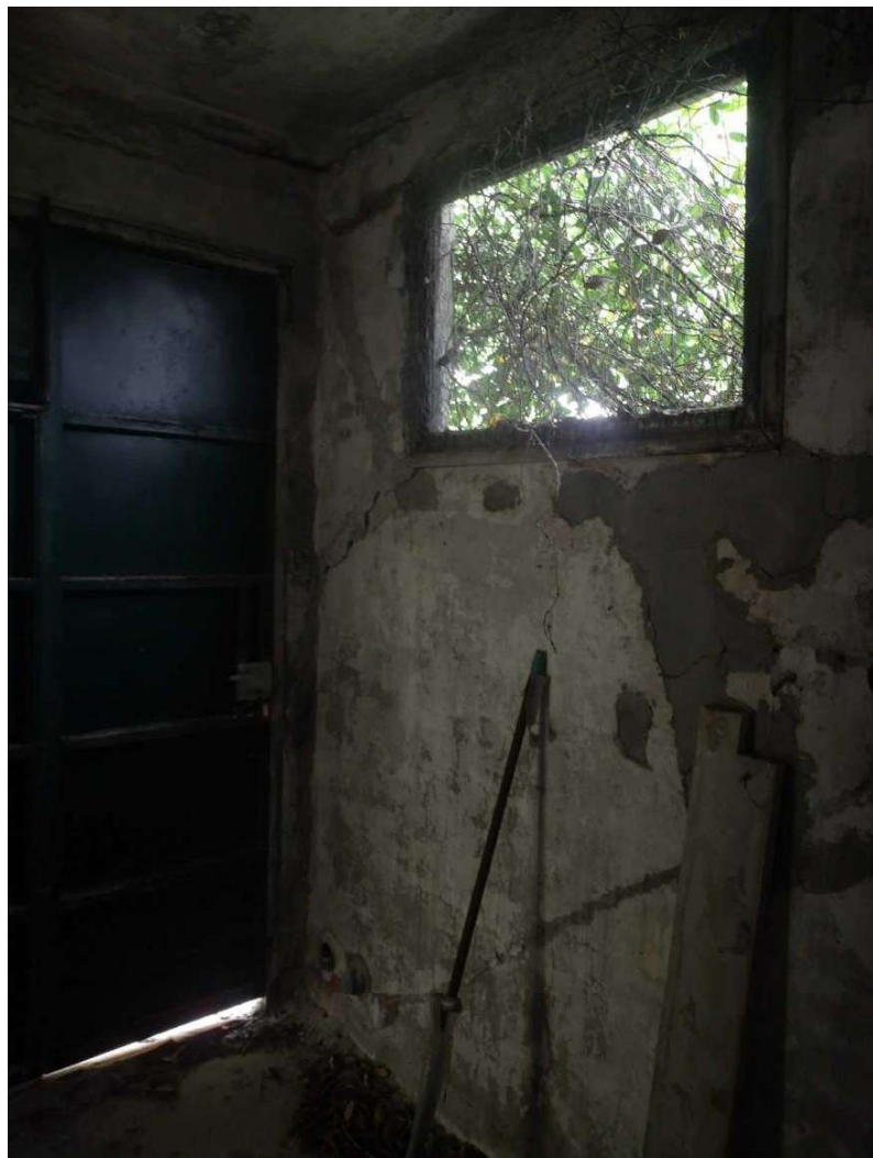
Accesso ovest alla calderina
